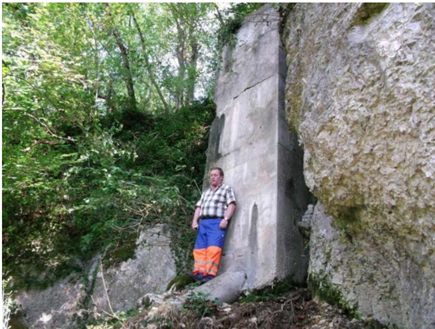
Abbildung 3: Durch Grundbruch freigelegter Kontrollschacht KS188
