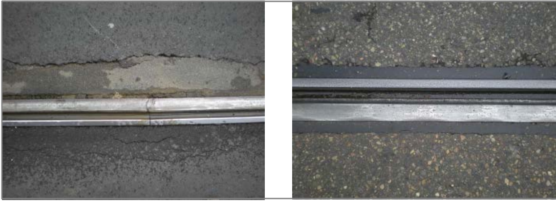
Abbildung 5: Typische Schadensbilder wie Belagsschäden infolge Gleissenkung, Schienenbruch, minimale Rillentiefe (Aufnahme links), starke Riffelbildung, minimale Rillentiefe (Aufnahme rechts)
