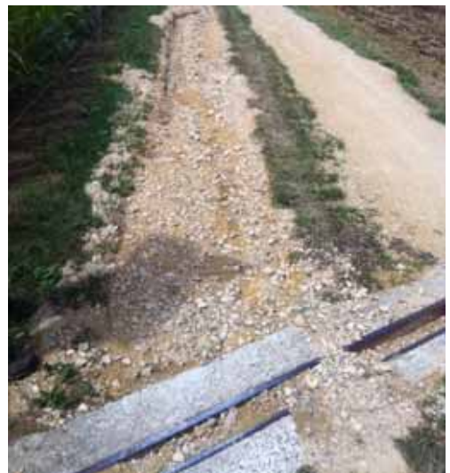
Querabschlag ist voll und kann das Wasser nicht mehr abführen, Augst.
