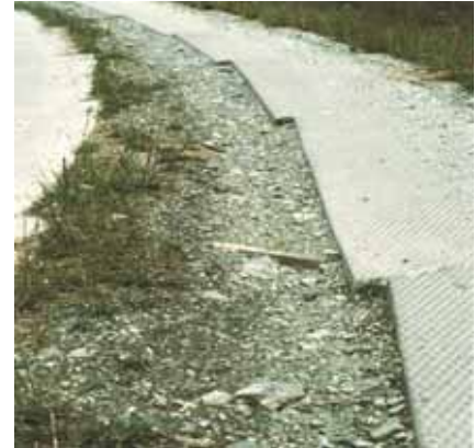
Auswaschung von Material zwischen den Fahrspuren. Das in der Mitte fliessende Wasser kann den Weg nicht verlassen.
