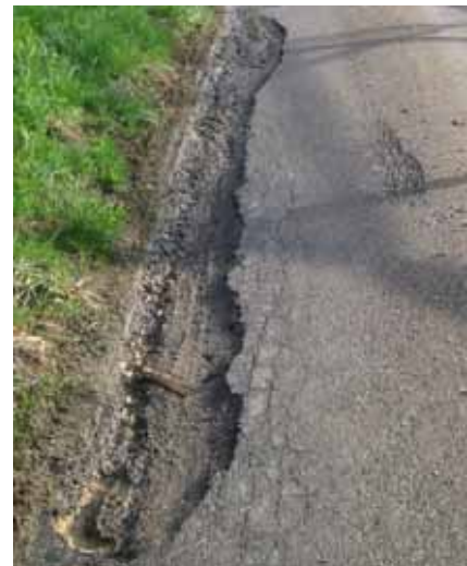
Foundationsschicht ist nicht ausreichend tragfähig. Aus Netzzissen entstehen mit der Zeit Schlaglöcher, Bennwil
