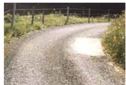
Altersbedingte Ausmagerung des Deckbelages.
