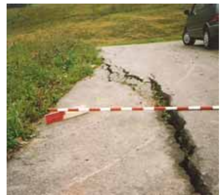
Setzung des Wegoberbaus in Folge Abrutschen der Böschung.
