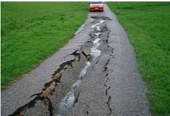
Einbruch des Hartbelages auf Grund von Unterspülung während eines Unwetters, Reigoldswil
