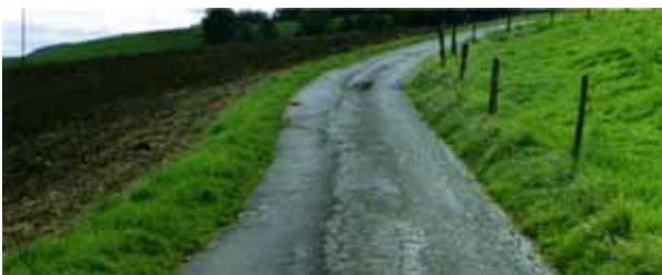
Aufgrund eines zu hohen Erd- und Graswalls am linken Wegrand kann das Niederschlagswasser die Strasse nicht regelmässig verlassen. Das anfallende Wasser konzentriert sich. Ein Abranden wäre sinnvoll.
