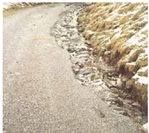
Der Seitengraben ist eingewachsen und kann deshalb nicht mehr ausreichend Wasser aufnehmen.
