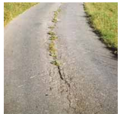
Mittelriss in einem Asphaltweg
