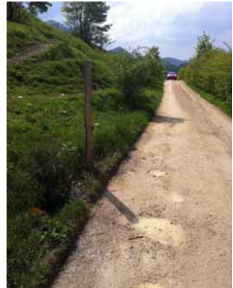
Schlaglöcher auf Mergelweg, Waldenburg
