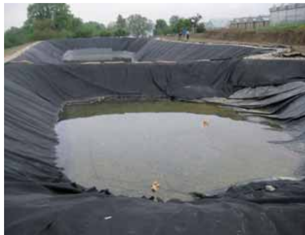
Gemeinde Füllinsdorf: Wasser-Speicherbecken eines Gemüsebaubetriebs zur Sammlung des gesamten Jahresniederschlags; im Vordergrund: Teich als ökologische Ausgleichsmassnahme.
