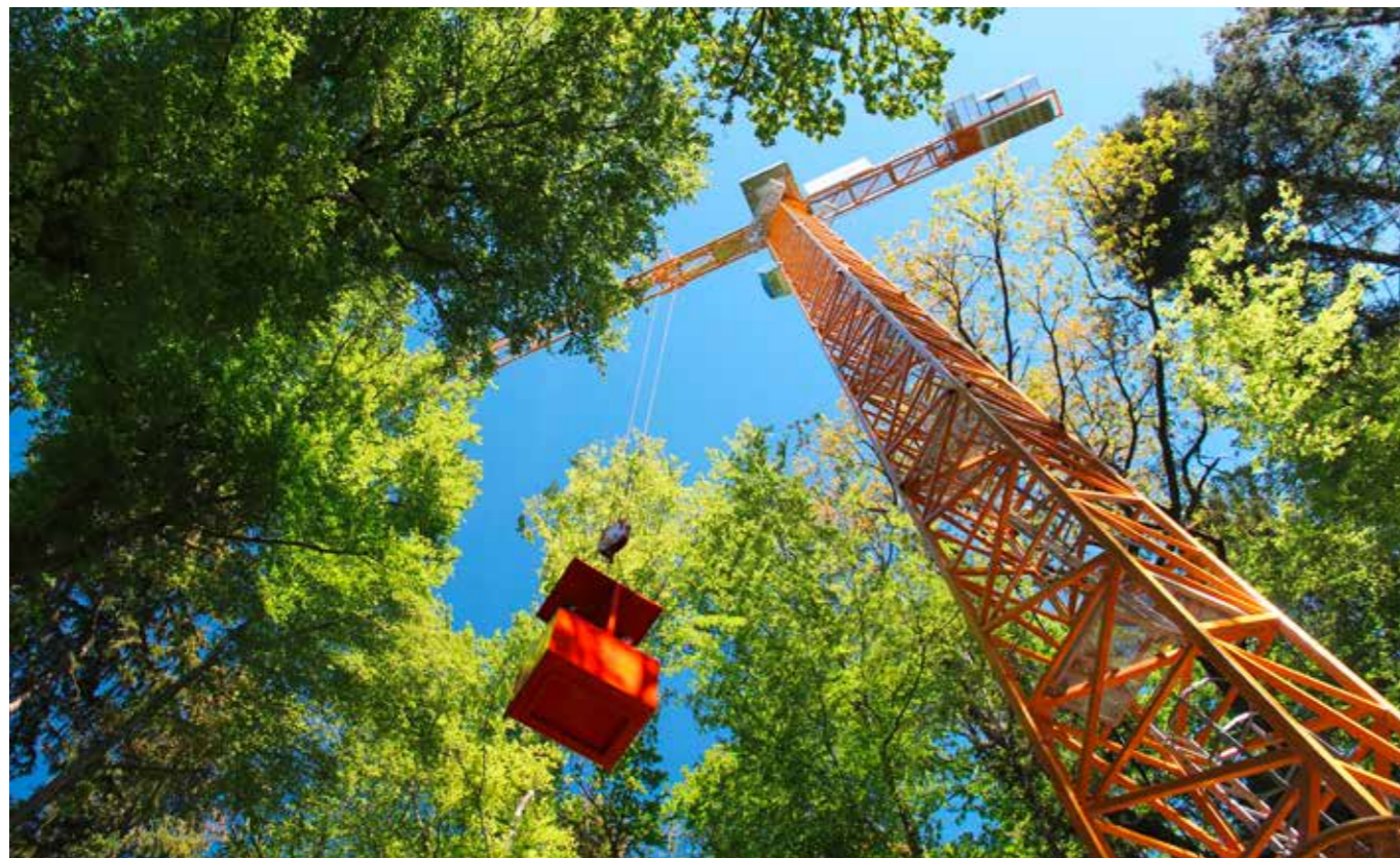
Der 50 Meter hohe Spezial-Baukran in der Mitte der Versuchsfläche. (Bild: Universität Basel)
