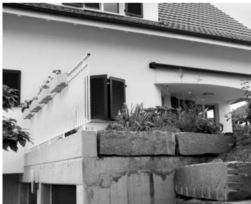
Diese ungesicherte Konstruktion ist nicht erlaubt, es fehlt noch ein Geländer.
