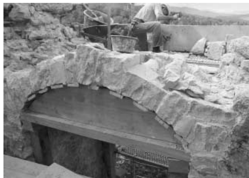
Der Scheitelbogen ist neu aufgesetzt, die benötigten Steine für den Wiederaufbau werden einzeln zugehauen.
