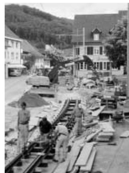
Woche 2 6. Juli Die Geleise werden in Etappen von 45 Meter pro Tag verlegt und einbetoniert. Bereits werden erste Masten gesetzt.
