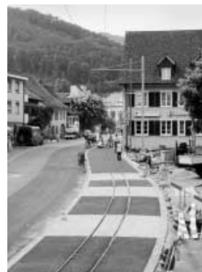
Woche 5 27. Juli Der rote Streetprint-Belag (eingepresste Musterung aussehend wie verlegte rote Betonsteine) wird eingebracht. Überall sind Detailarbeiten im Gang.
