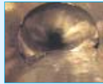
Gerissene Rohrwandung im Sohlenbereich
