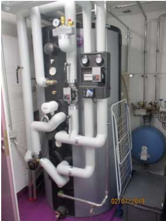
Abbildung 8: Speicherstutzen sind bis an die Speicherdämmung gut gedämmt. Die Wärmeverluste werden so niedrig gehalten.
