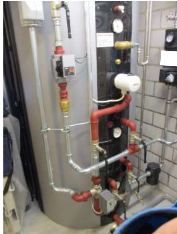
Abbildung 9: Warmwasserspeicher ohne Dämmung der Anschlüsse. Der WW-Thermosiphon wurde hier aber ausgeführt.
