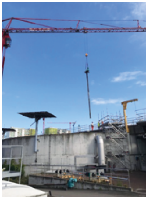
ARA Birs in Birsfelden in Richtung Freulerquartier (oben) und die Demontage des Rührwerks (rechts) in der ARA Birs.
