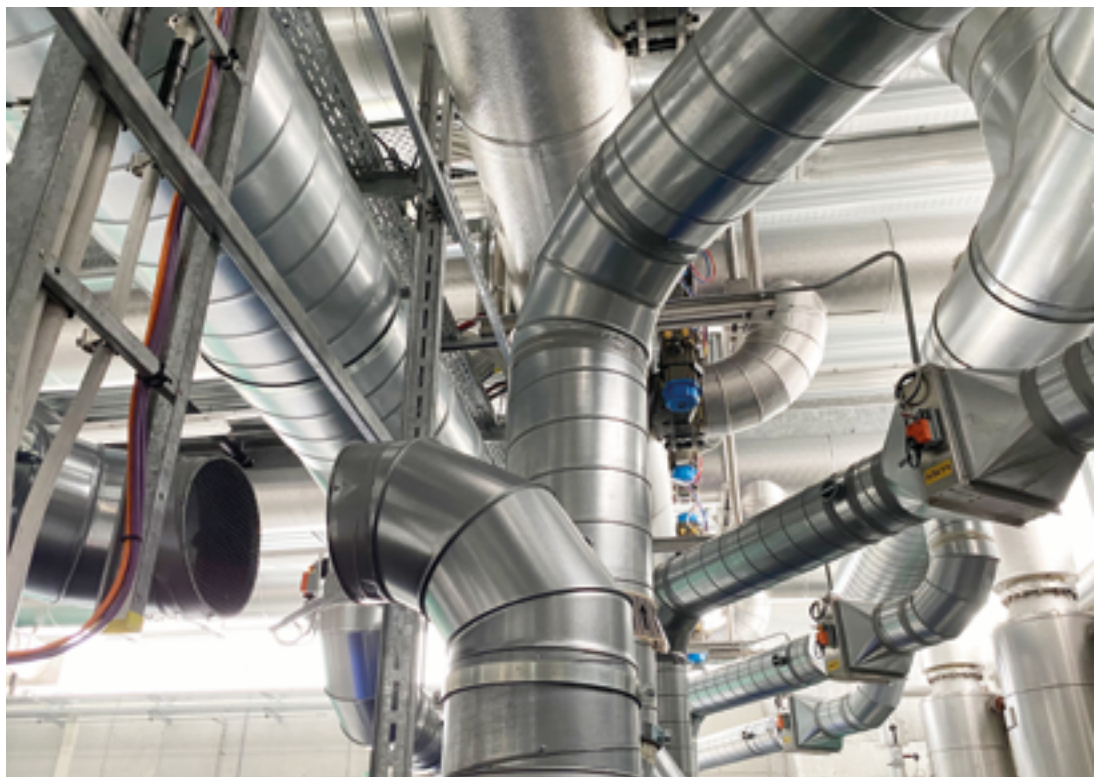
Abluft Gebläsestation ARA Birs
