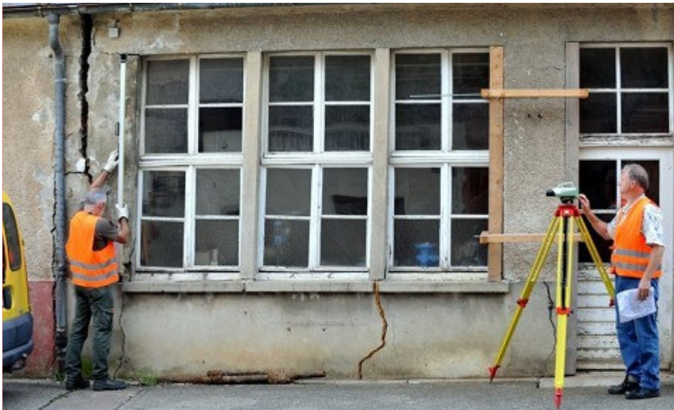
Staufen: Risse an über 200 Gebäuden
