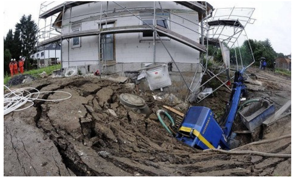
Kamen: Sandlinie über Hohlraum?
