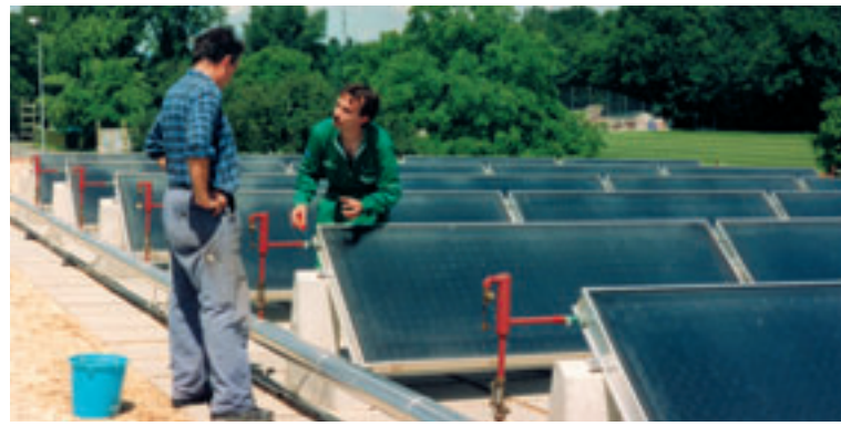
Foto: SOLBAU GmbH, Bubendorf
