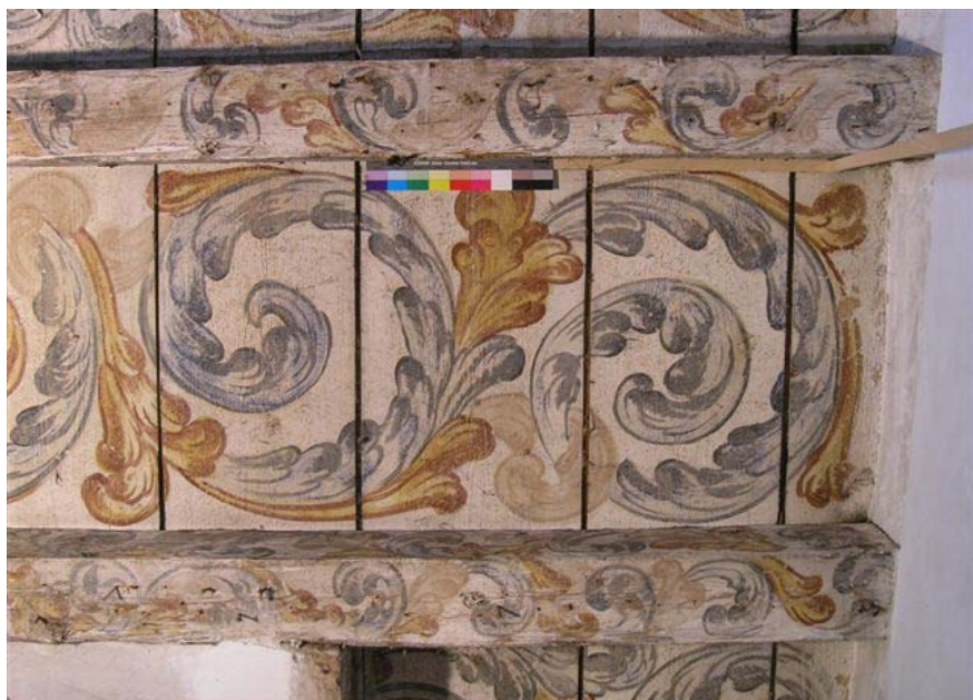
Sondieröffnung mit Blick auf die darunter liegende, bemalte Balkendecke Die freigelegte Balkendecke im 1. Obergeschoss. Fotos: Stefan Buess, Gelterkinden
