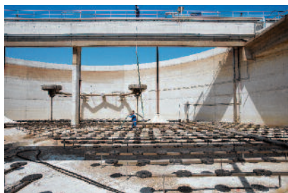
Abb. 5 Blick ins Innere eines Reaktors mit feinblasiger Membranbelüftung, Rührsystem (total vier Rührwerke) und Dekantiervorrichtung mit total vier Dekantern.
