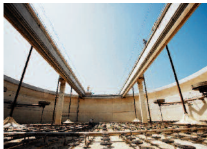
Abb. 6 Stege über die SBR-Becken mit Schwimmschlammräumung und den vier Dekantern.
