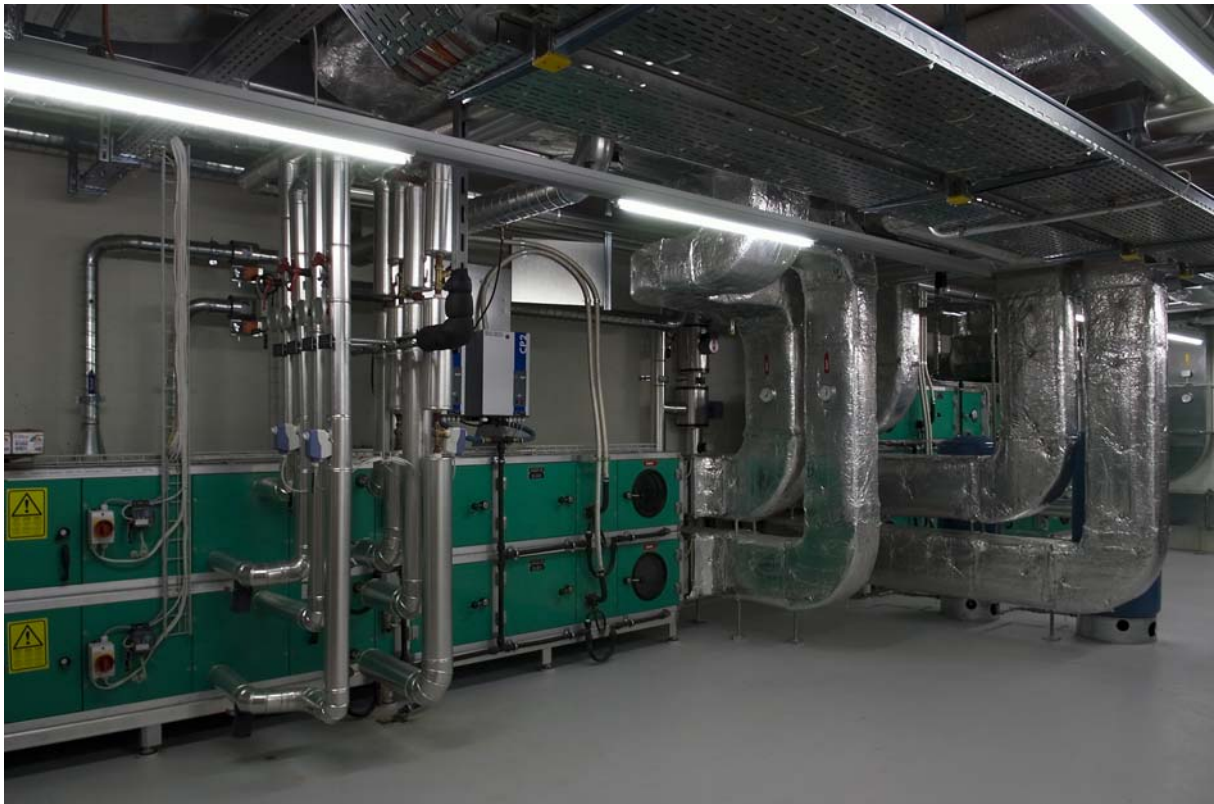
Bild 4 Hightech im Technikraum
